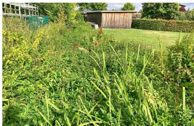
Die Regenwassereinläufe mit Zugang zum Zierker See sind zugewuchert.
